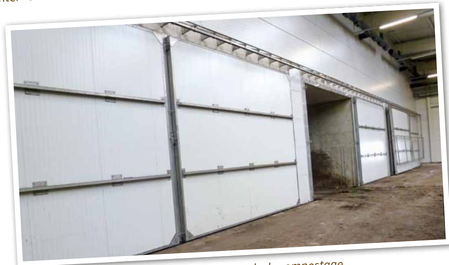
Die Rottetunnel · Tunnels de compostage
